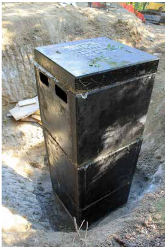
Grotta delle Pisoliti: protezione dell'ingresso con elementi prefabbricati: si notino le feritoie per i pipistrelli (Gessi Bolognesi).
